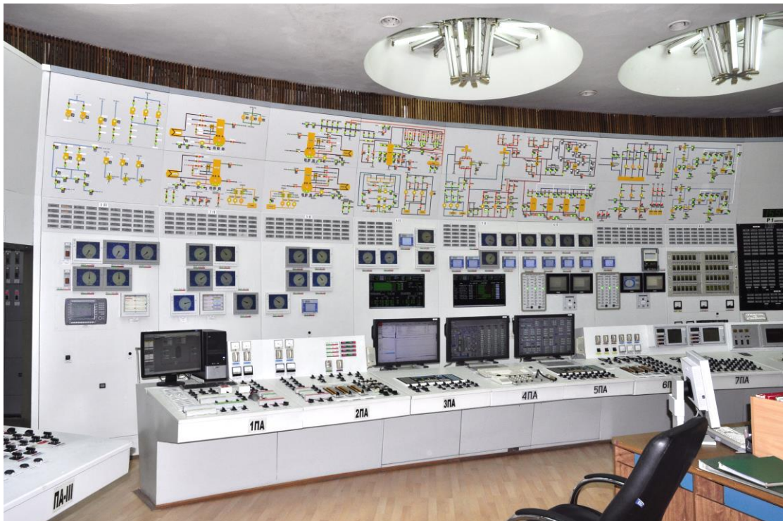
Рис. 3. БЩУ енергоблоку АЕС
